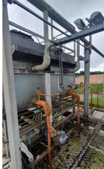
Figura 7: Condensador evaporativo desativado
