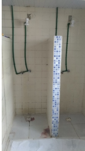
Figura 5 – Chuveiros instalados no banheiro
