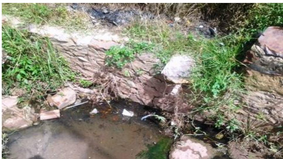
Figura03 - Esgotos e fossas despejados na galeria
