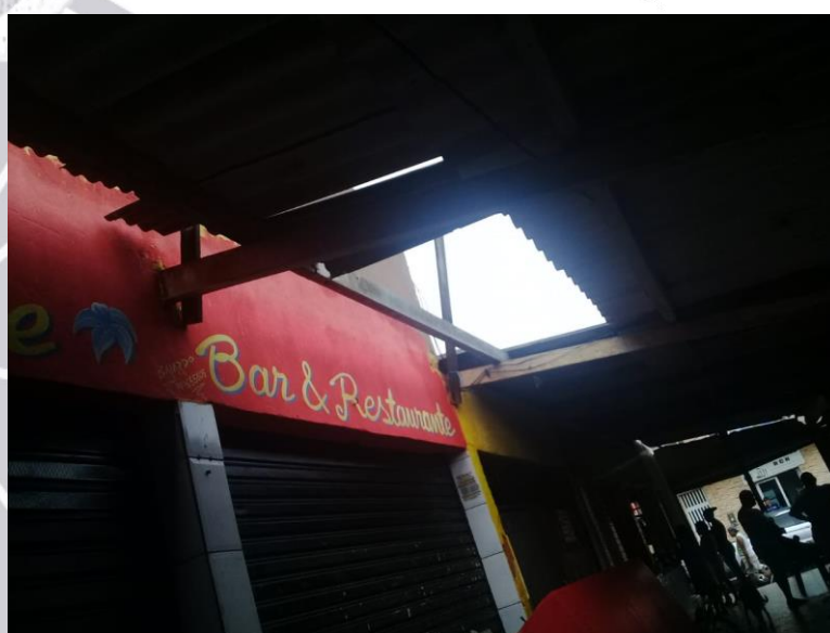
Fonte: Próprio autor Figura 7: Telhado destruído pela chuva
