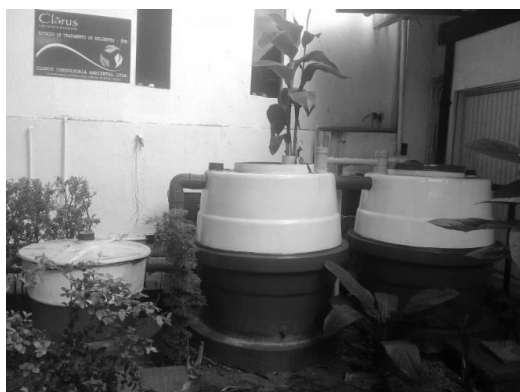
Figura 2. Estação de Tratamento de Efluentes
