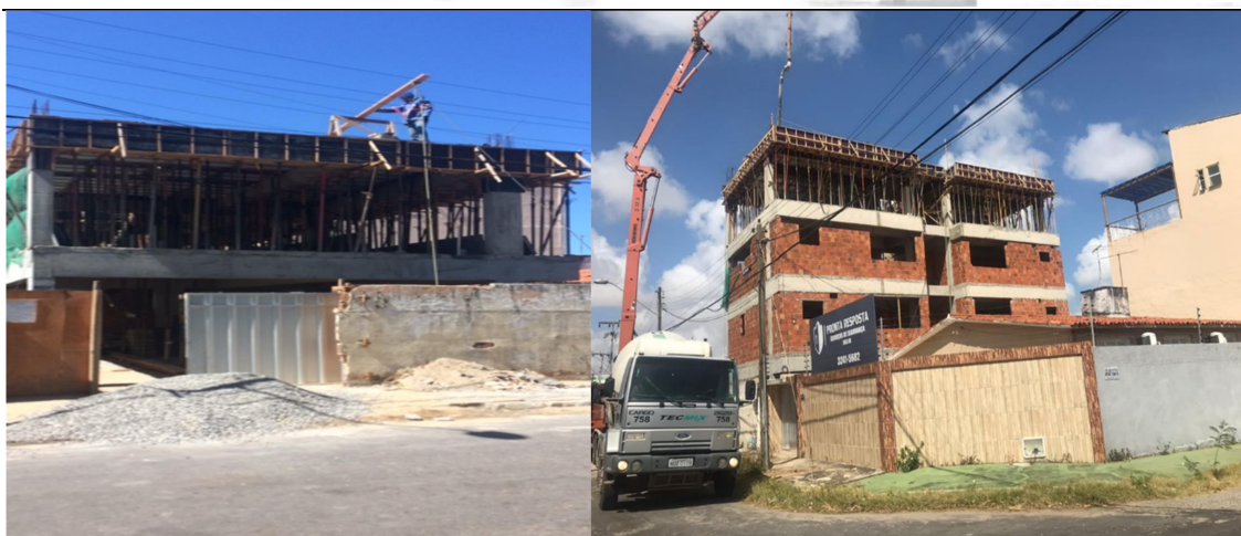
Figura 03 – Estágios da obra: (a) Concretagem da segunda laje (15/10/2017) (b) Concretagem da quarta laje (07/12/2017)
